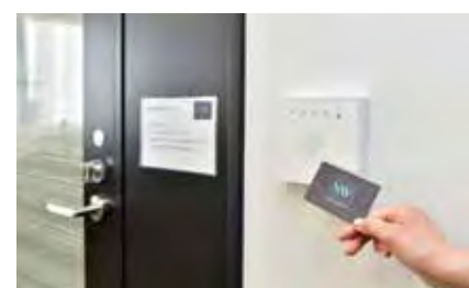
入退室時にかざすライセンスカードは、IC乗車券や社員証でもおなじみのFeliCaカードを選択。NewWorkでも、セキュリティ・勤怠管理・全国共通利用など重要な役割を担う。利用者には勤務先から1人1枚支給される。
